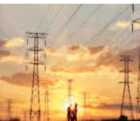
कंपनी का कारोबार बढा दें कि जयपुर की कंपनी आरएमसी स्विचगियर्स एक पावर टेक्नोलॉजी कंपनी है। कंपनी विजली की चोरी से निपटने और बिजली के झटके से होने वाली दुर्घटनाओं को रोकने में माहिर है। यह विनिर्माण, आपूर्ति, स्थापना और संचालन एवं रखरखाव (ओ एंड एम) प्रबंधन को शामिल करने वाले समाधान भी डिजाइन करता है।
